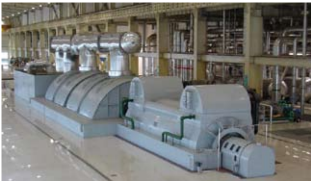
東方集団との協業による電源プラント 山東鄒鄒四期発電所 7 号機 1000 MW 超超臨界燃焼発電機組
